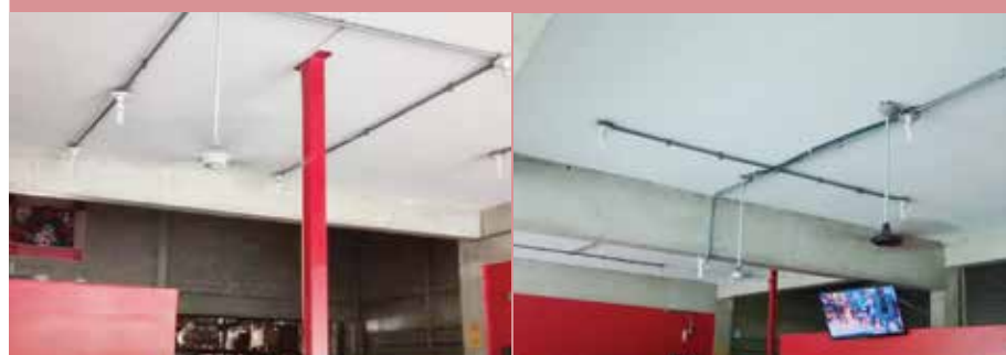
Ventiladores rodam fora do eixo e podem cair na cabeça dos trabalhadores a qualquer momento
